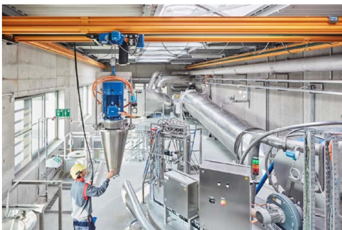
Neue Anlage für Reduktionsmittel
